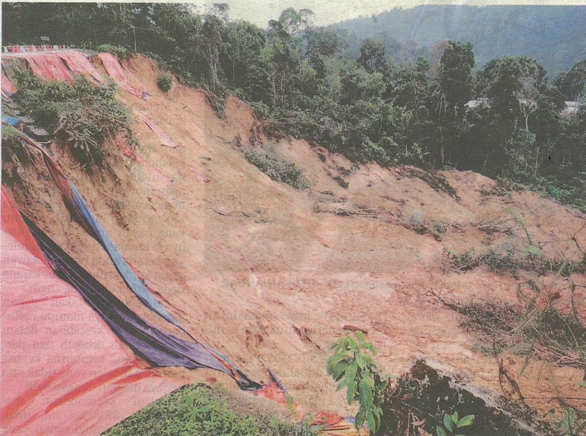
TANAH runtuh di Batang Kali, Selangor antara contoh pelantikan kontraktor secara runding boleh dibuat terus bagi kerja-kerja pembaikan dilaksanakan segera. - GAMBAR HIASAN
